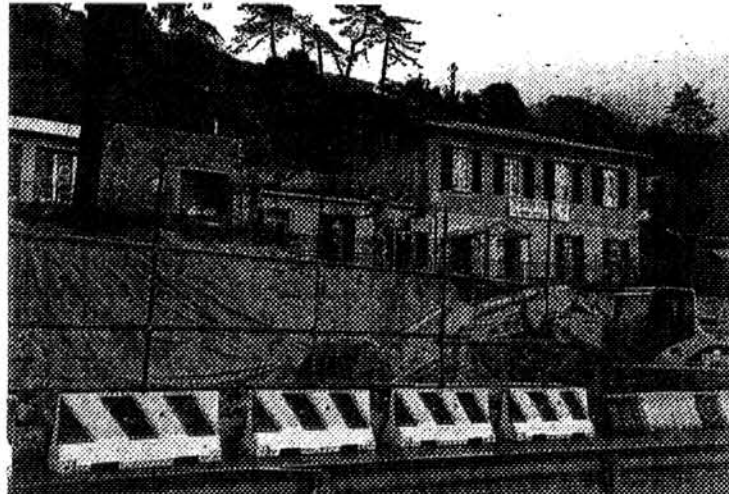
Il muro pericolante abbattuto un mese fa, a Cavi. Sullo sfondo, l'asilo
